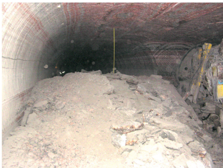
Рис. 1. Внезапное разрушение пород почвы выработки, сопровождающееся газовыделением (13.04.2005 г., рудник I РУ, верхний сильвинитовый пласт I калийного горизонта, сопряжение конвейерного штрека лавы с технологической сбойкой)
