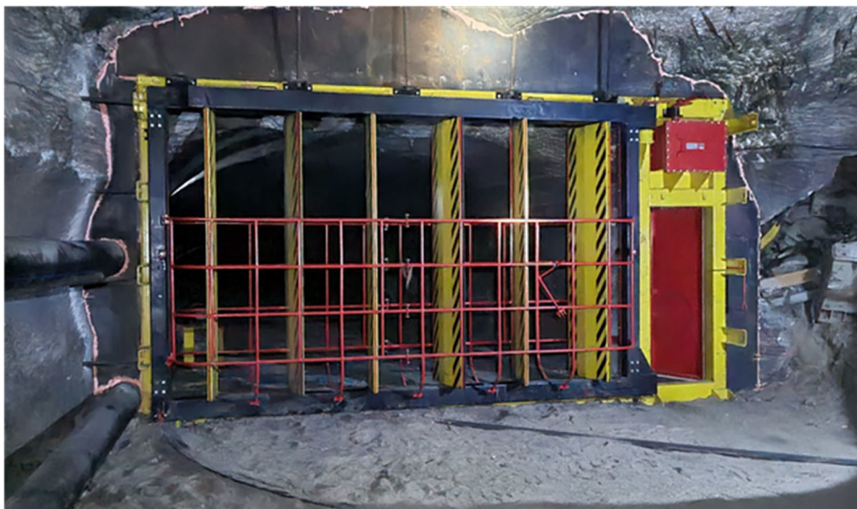
Рис. 1. Автоматическая вентиляционная дверь в условиях рудника
