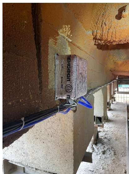
Рис. 4. Внешний вид модуля системы гидронивелирования
