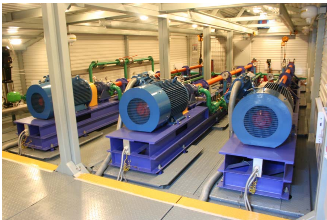
Рис. 7. Станции поддержания пластового давления
