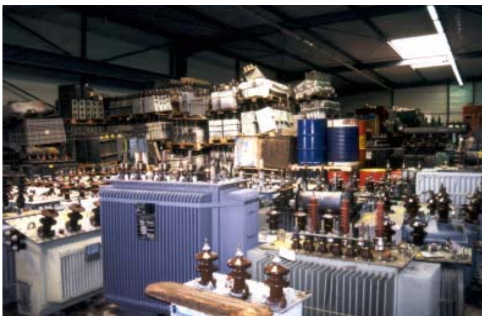
Рис. 2. Электрооборудование с ПХБ
