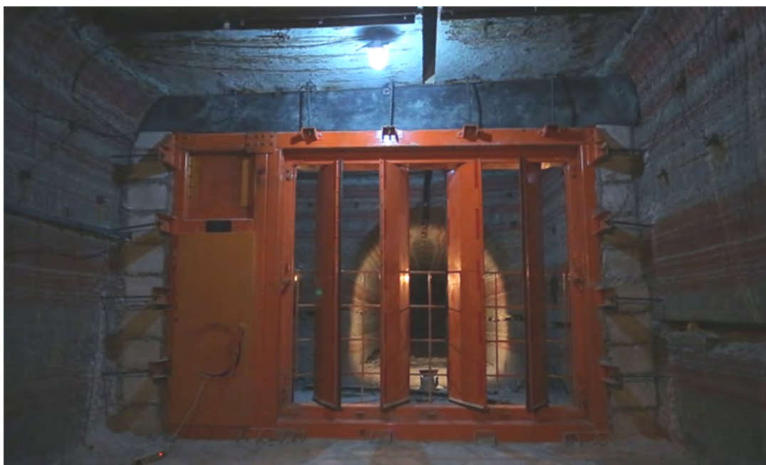
Рис. 4. Регулирование расхода воздуха по выработке с помощью автоматической вентиляционной двери
