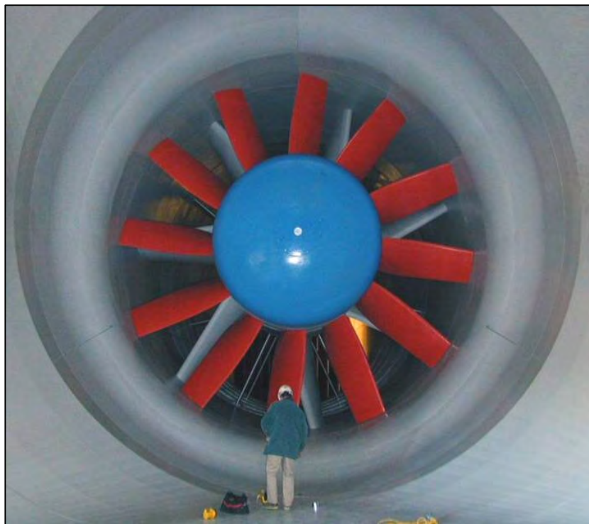
Рис. 2. Агрегат шахтной вентиляторной установки
