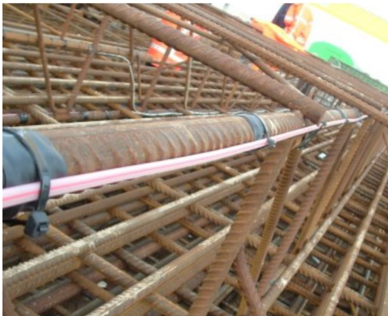
Рис. 14. DSS кабель в железобетонной конструкции
