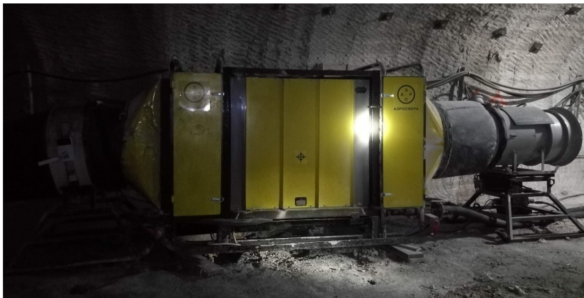
Рис. 2. Воздухоохладитель и вентилятор местного проветривания установленной системы кондиционирования воздуха
