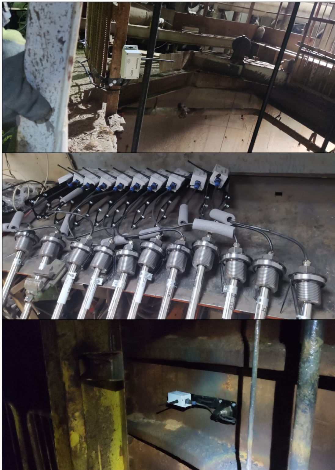
Рис. 7. Цифровые термометрические датчики на строящемся шахтном стволе Гремячинского ГОКа. Сверху-вниз: приемник станции сбора данных на устье ствола, внешний вид датчиков с радиомодулями и датчик, установленный в тубинговой крепи
