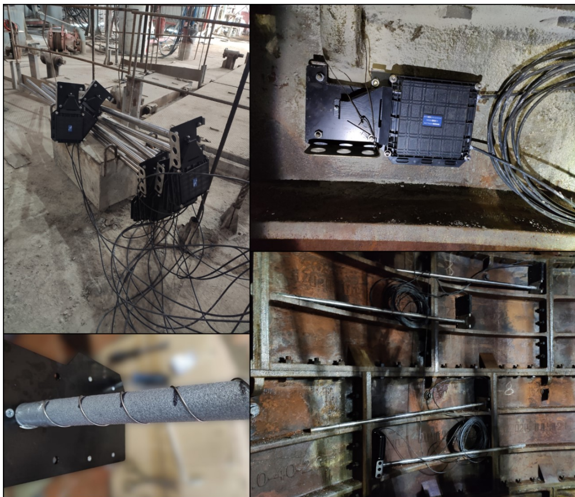
Рис. 4. Оптоволоконные датчики 2-го поколения (Дарасинский рудник)
