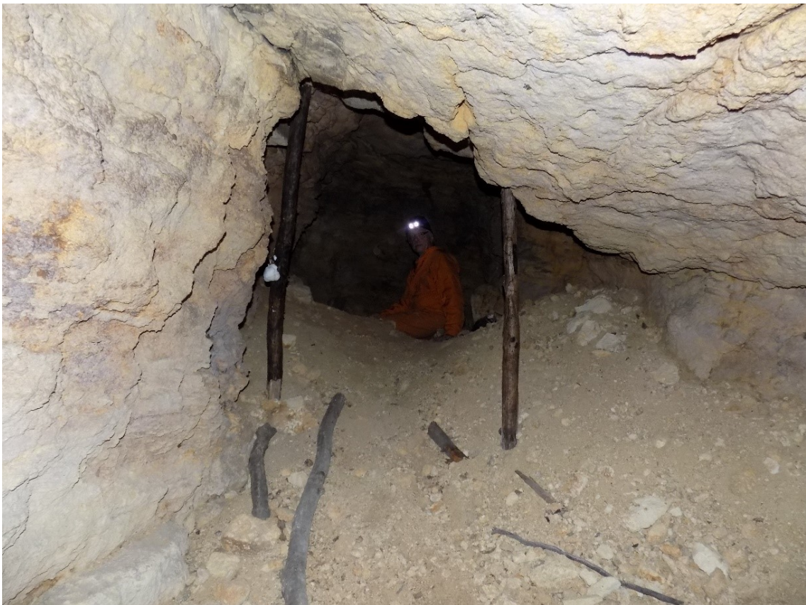
Рис. 9. Увеличение наклона кровли после тектонической трещины
